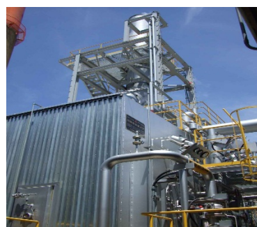
ガス専焼ボイラー
