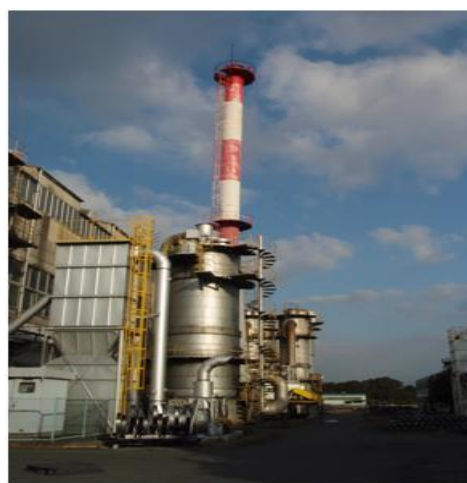
図－4 焼成炉排ガス処理設備
