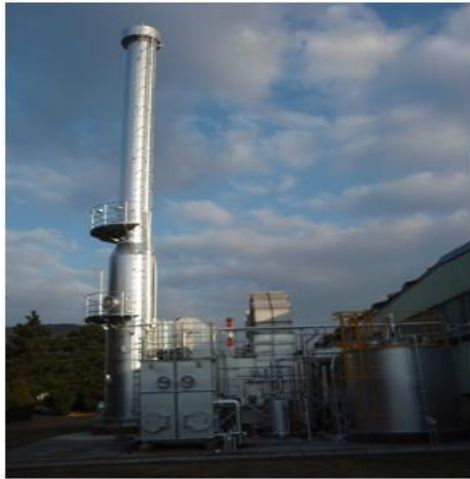
図－５ 黒鉛化炉排煙脱硫設備
