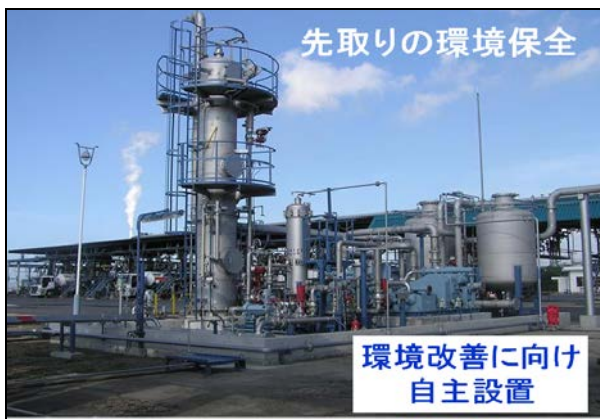
(ローリー出荷設備の排ガス回収設備)
