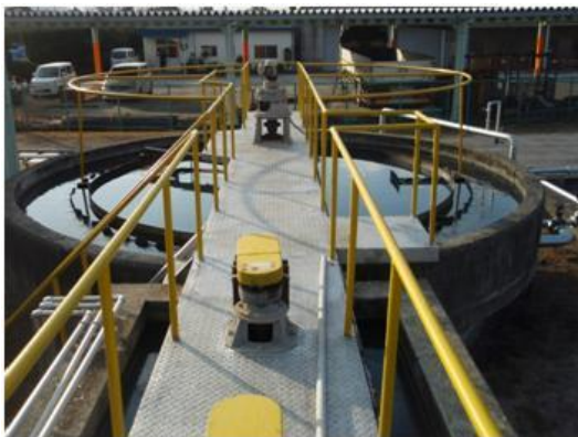
図－６ 工場排水処理設備
