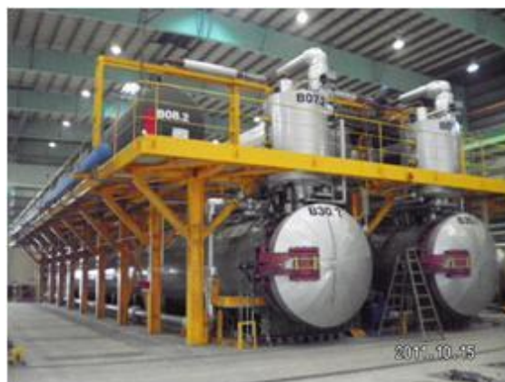
図－3 新型浸透設備
