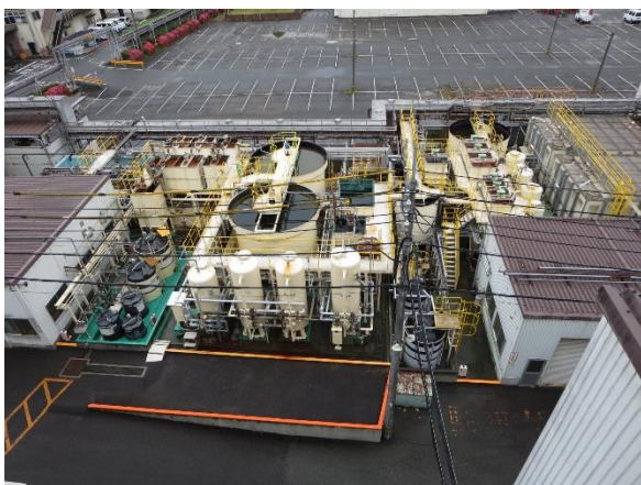
排水処理設備
