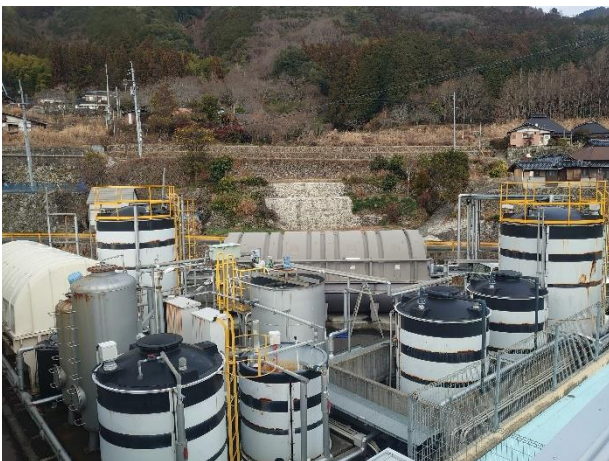
写真：第2蔵排水処理設備
