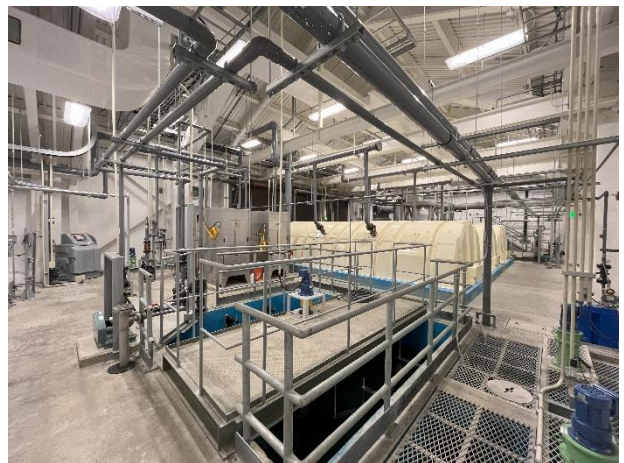
写真：ニューヨーク蔵排水処理設備
