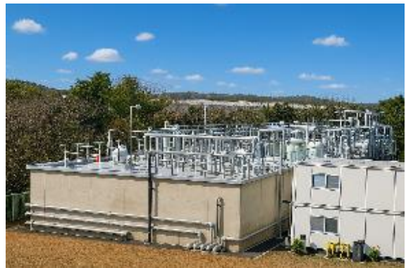
写真4) 排水処理設備
